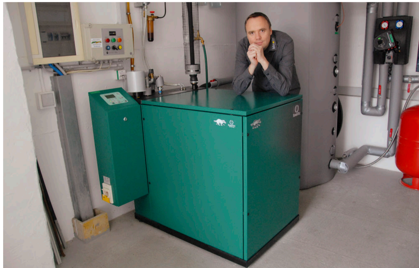
Die Nachfrage nach Blockheizkraftwerken sei gross, sagt Andreas Born. Eben hat seine Firma in Oberbalm eine solche Anlage umgesetzt, die gleichzeitig Wärme und elektrischen Strom herstellt.
